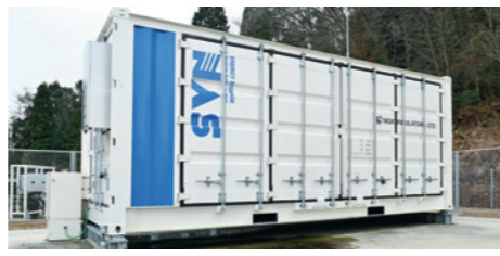
NAS電池は、正極にナトリウム(Na)、負極に硫黄(S)を用い、固体電解質を介したナトリウムイオンの授受により充放電を行う。
